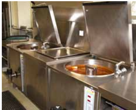
Rückkühlkessel fürs Cook & Chill-System.
