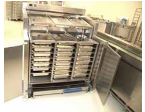
Bestückte Kühlstationen sorgen für Vollhygiene.
